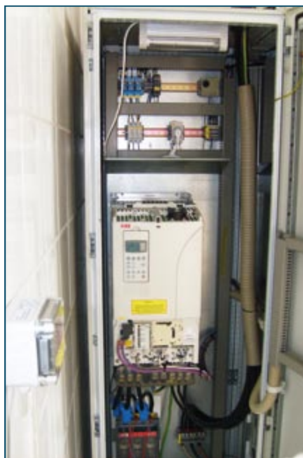
Fot. 2. Widok wnętrza szafy z przetwornicą
