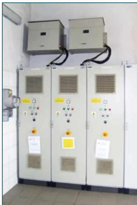
Fot. 1. Szafy z przetwornicami częstotliwości
