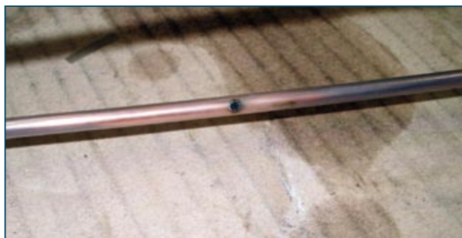
Fot. 3. Widok miejsca uszkodzenia izolacji drutu nawojowego uzwojenia stojana
